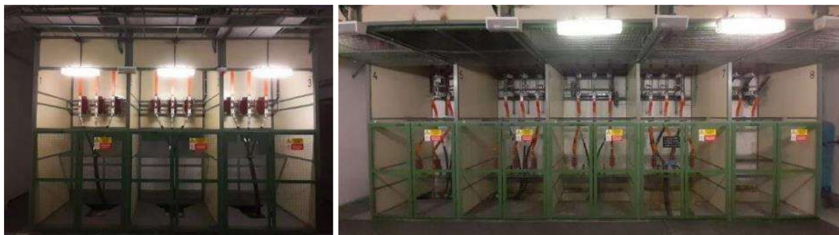
Obr. 2. kobky s privodnými káblami vedenia PVE LM 519 m n.m.
