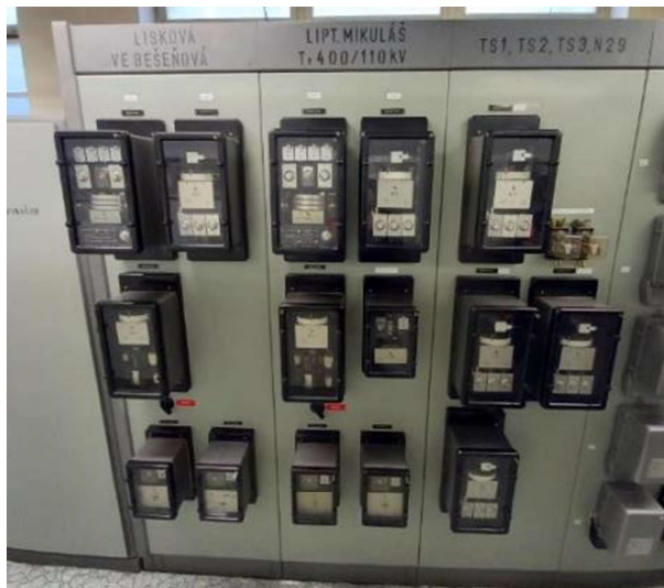
Obr. 6. Elektromechanické ochrany 22 kV pre prívodné linky a transformátory vlastnej spotreby
