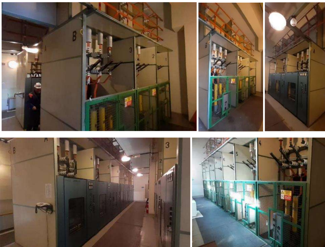
Obr. 1. kobky rozvodne 22 kV 1÷4 PVE LM 525 m n.m.
